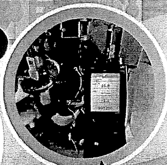
空調主機檢測
